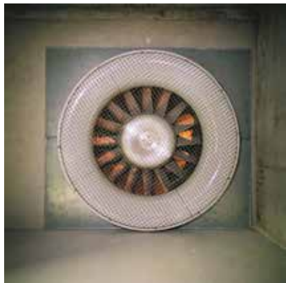
Применение в вентиляционных установках
