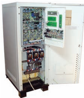
Внутренняя компоновка устройства
